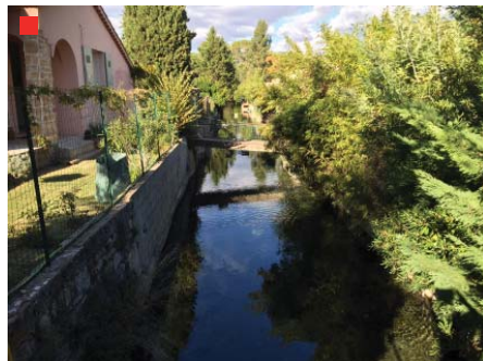
Les reprises de murs doivent se faire selon le même motif de maçonnerie (et non en parpaings, béton banché ou autre motif brut...).
