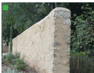
Les murs doivent avoir une épaisseur minimale de 40cm en référence à l'épaisseur des maçonneries traditionnelles (image de référence).
